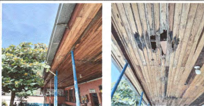
Foto 5: Modulo A Vista de Corredor con cielo falso en pesimas condiciones por goteras existentes.
