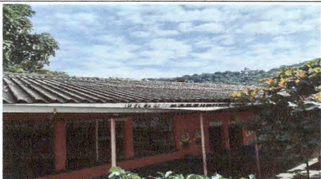
Foto 3: Modulo A, Vista de cubierta de Asbesto Cemento y canal en malas condiciones
