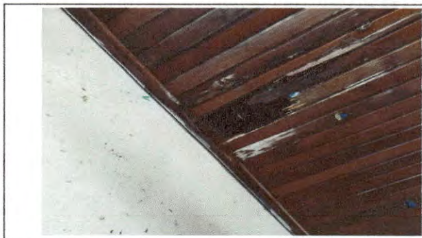
Foto 12: Modulo B Vista interna de aula y cielo falso de madera en mal estado.
