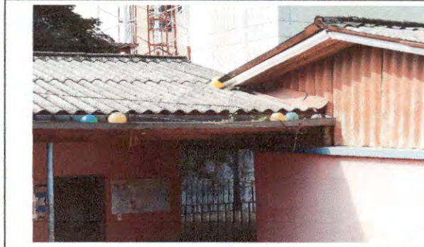
Foto 8: Modulo B Cubierta de Asbesto Cemento en mal estado, se debe de retirar el cielo falso de madera ya en mal estado y se cambiarian las canales existentes ya deterioradas.
