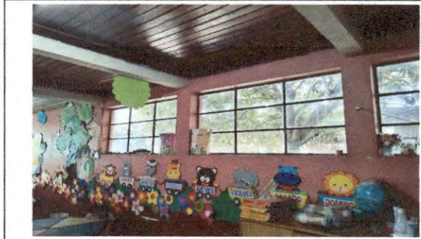
Foto 10: Modulo B vista interna de aula con cielo falso de madera en malas condiciones.
