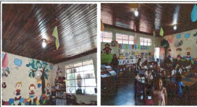
Foto 4: Modulo A vista interna de aula con cielo falso deteriorado por goteras que existen en el techo de Asbesto Cemento.
