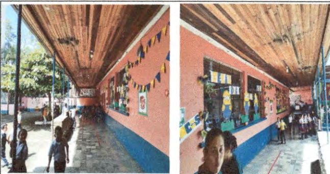
Foto 6: Modulo A Vista de corredor con cielo falso totalmente deteriorado.
