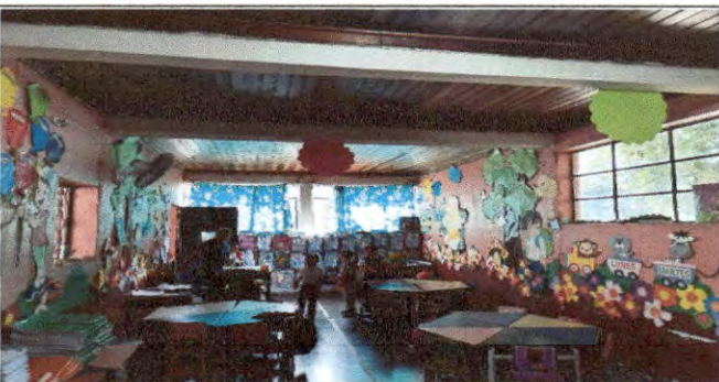
Foto 11: Modulo B Vista interna de aula , se desmnotara el cielo falso y se cambiara la estructura de madera con la cubierta de asbesto .
